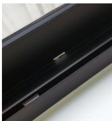
Orificios en los perfiles de las ventanas
